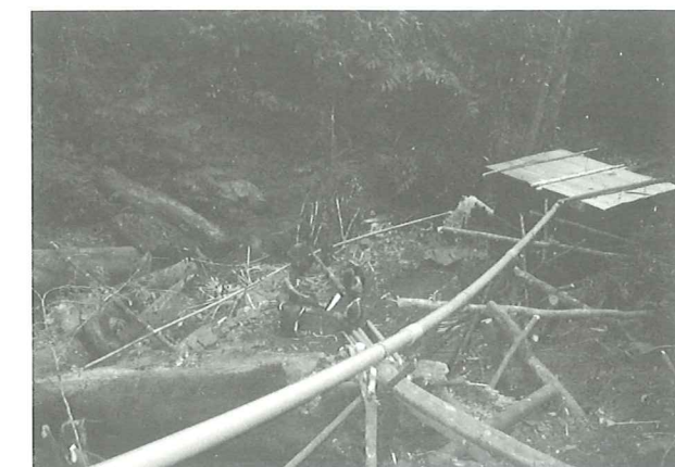
村民共同興建泰鄉村小型水力發電系統
