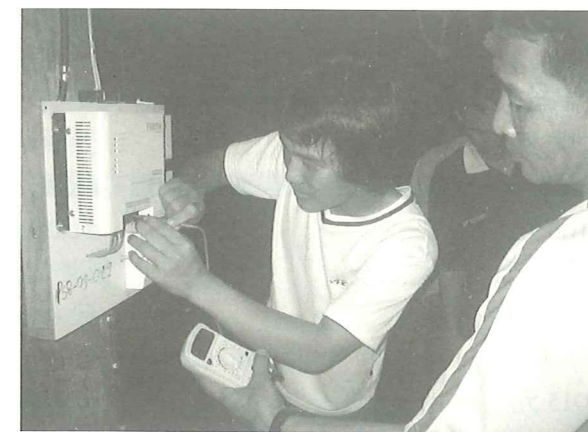
學員與講師正在測試太陽能發電系統
